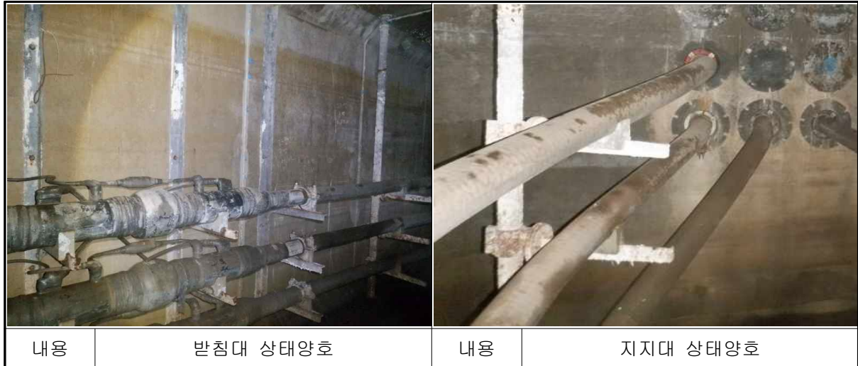
【사진 8.44】 부속 및 부대설비 현황
