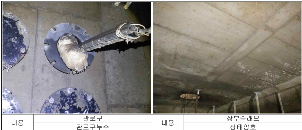
【사진 8.22】 맨홀 내부 주요 손상
