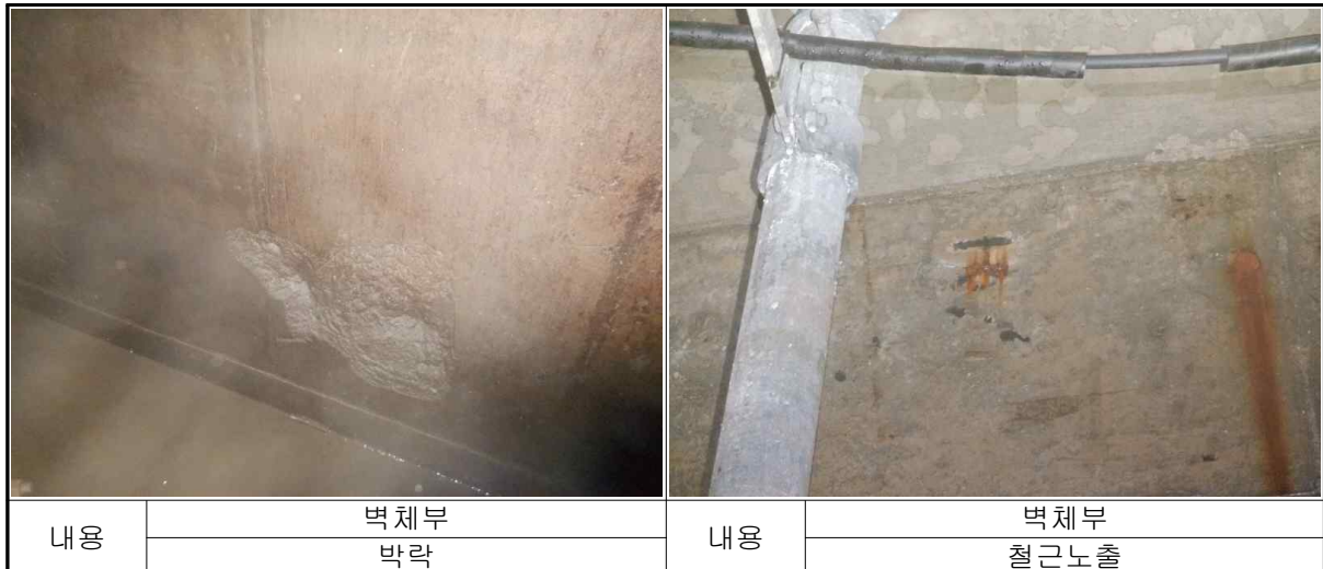
【사진 8.26】 맨홀 내부 주요 손상
