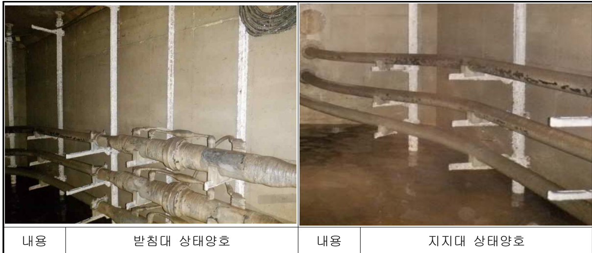
【사진 8.20】 부속 및 부대설비 현황
