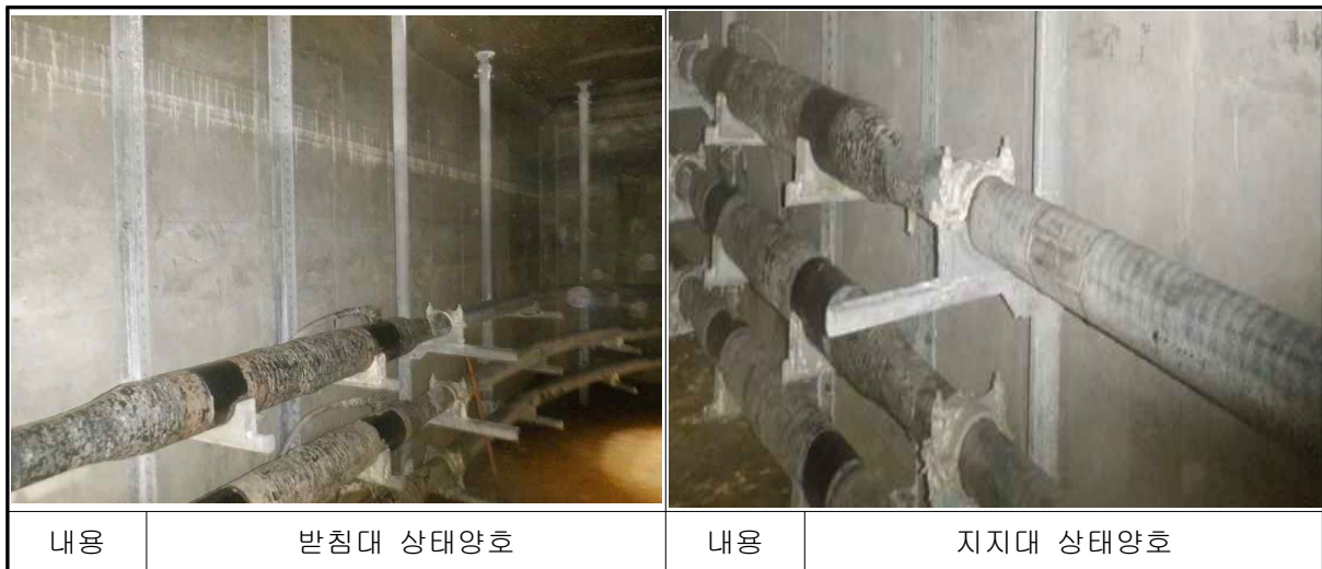
【사진 8.12】 부속 및 부대설비 현황
