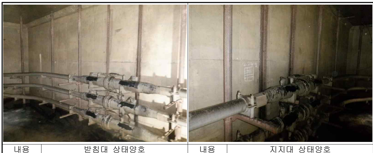
【사진 8.4】 부속 및 부대설비 현황
