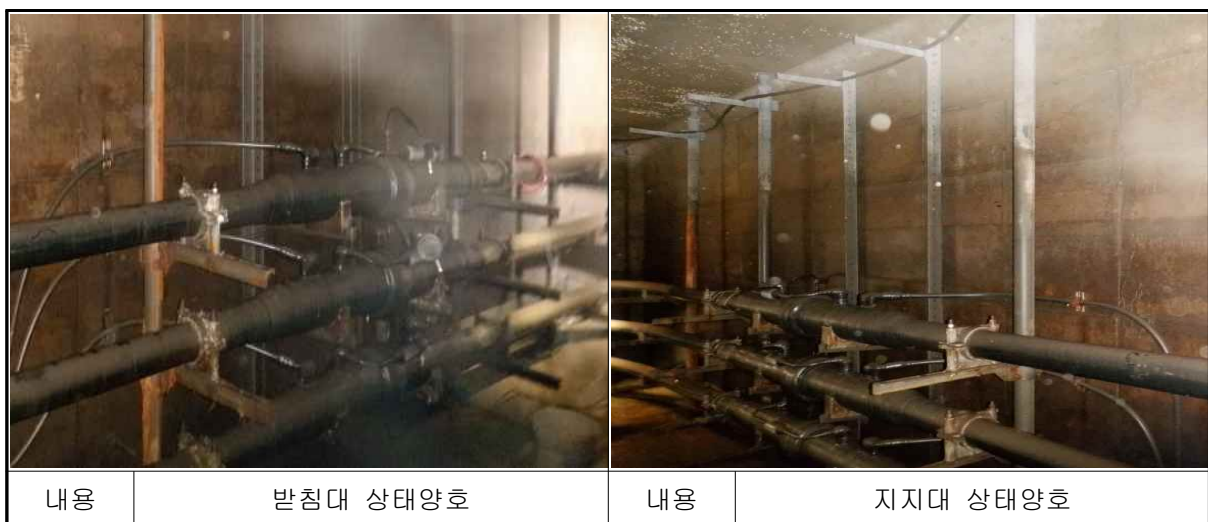
【사진 8.28】 부속 및 부대설비 현황
