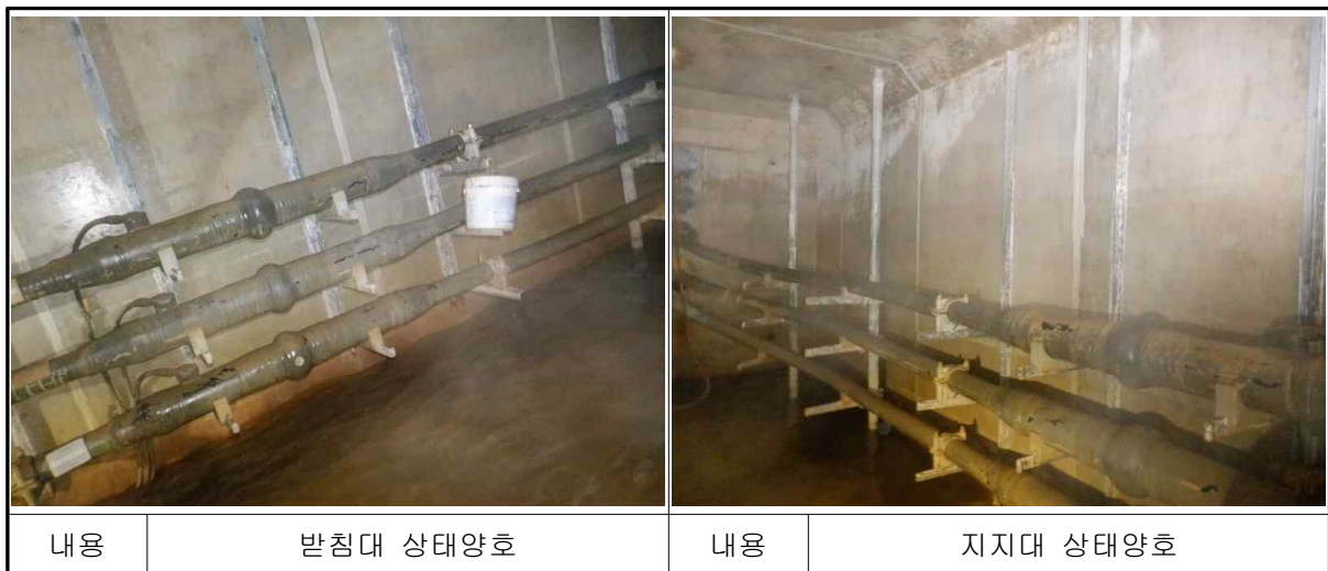
【사진 8.40】 부속 및 부대설비 현황
