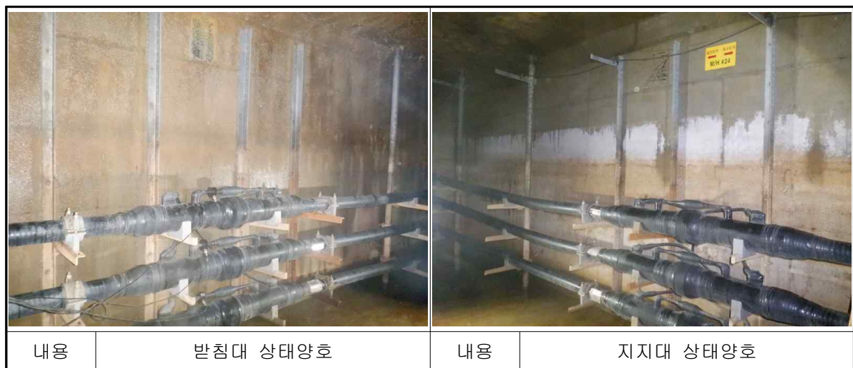
【사진 8.36】 부속 및 부대설비 현황
