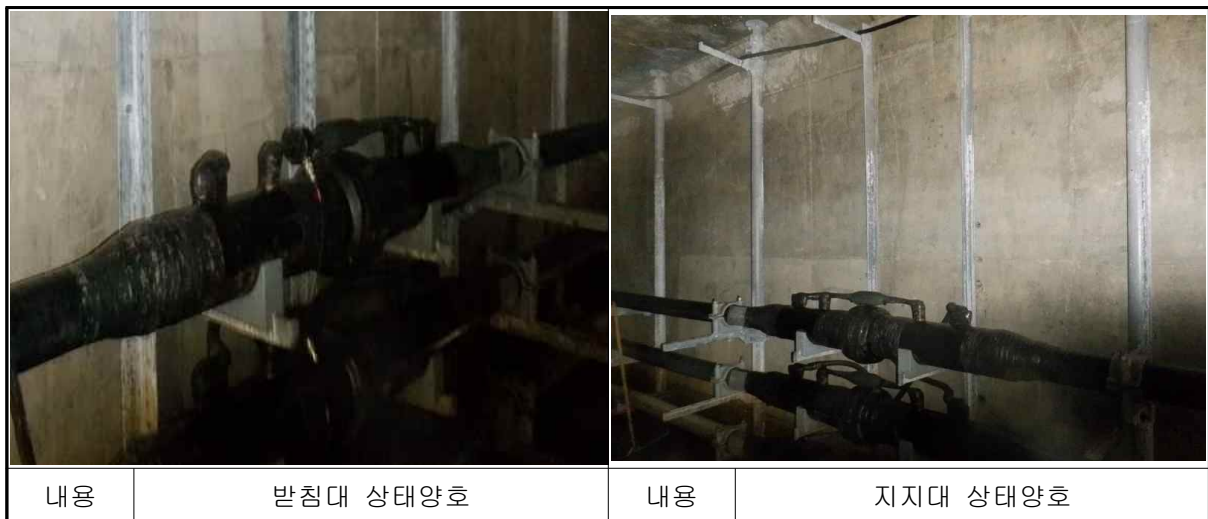
【사진 8.8】 부속 및 부대설비 현황
