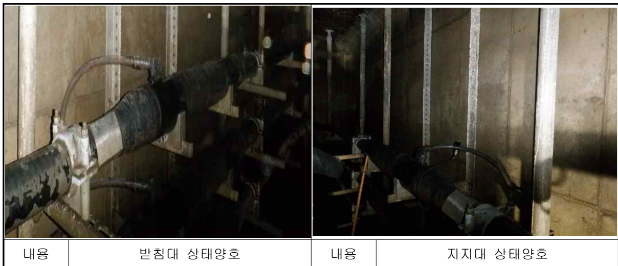
【사진 8.24】 부속 및 부대설비 현황
