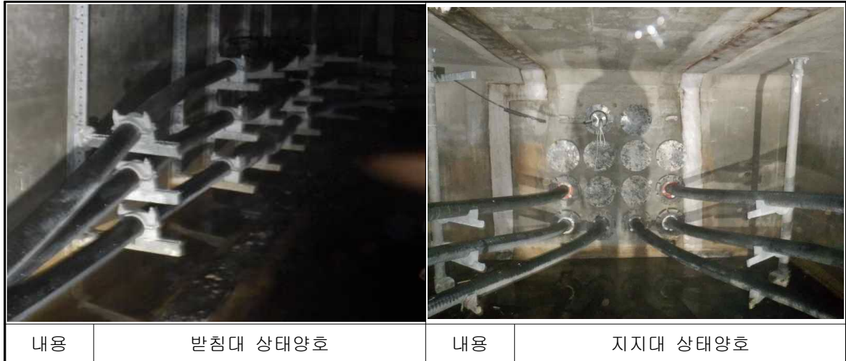
【사진 8.32】 부속 및 부대설비 현황
